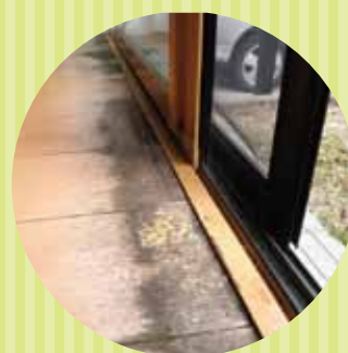
結露で発生したカビ
